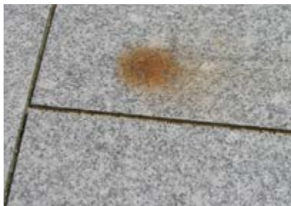
Rostiger Splitt im Unterbau
